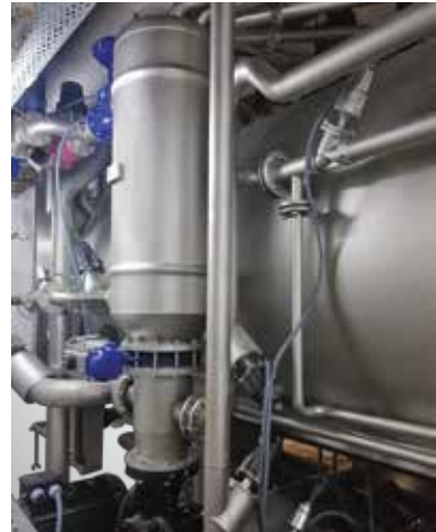
Eşanjör / Heat Exchanger
